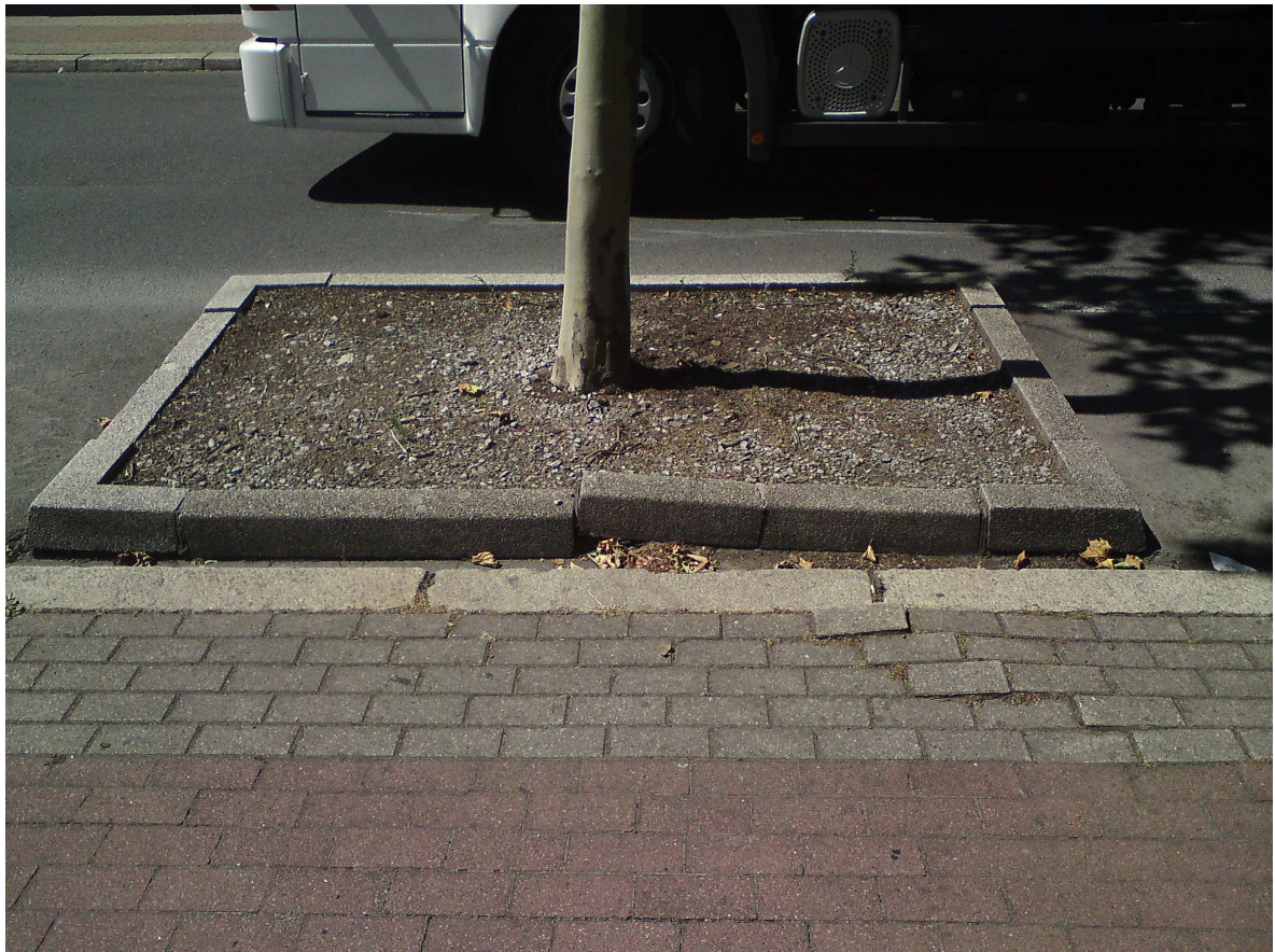
Wurzelerlauf bis unter den Gehweg / Radweg
